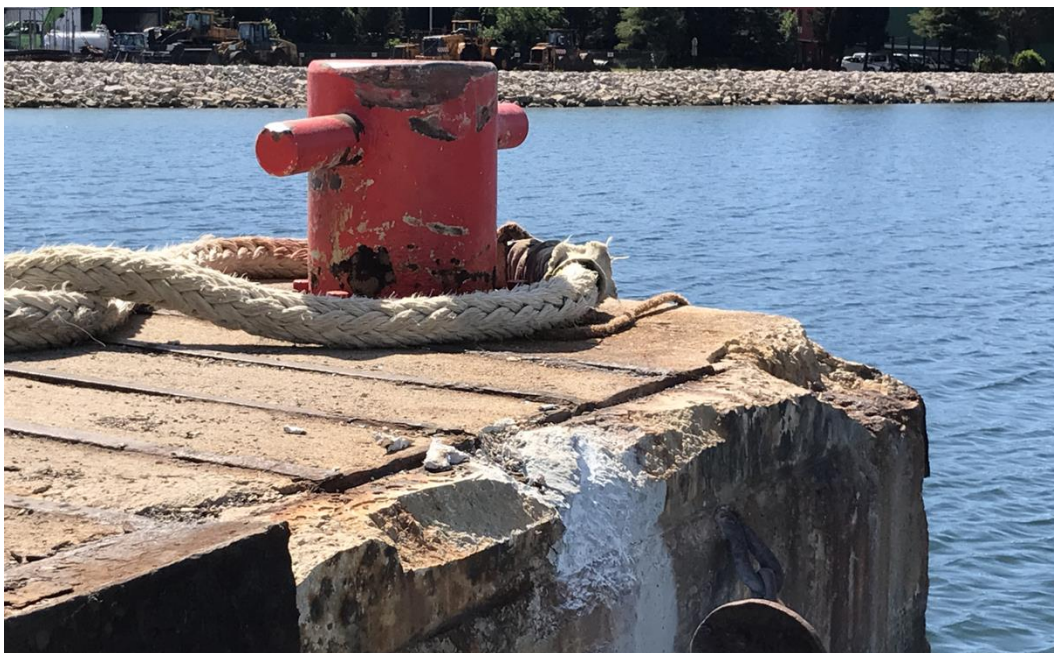
Slika 22 Poškodba pomola ob privezni bitvi na VNT terminalu
